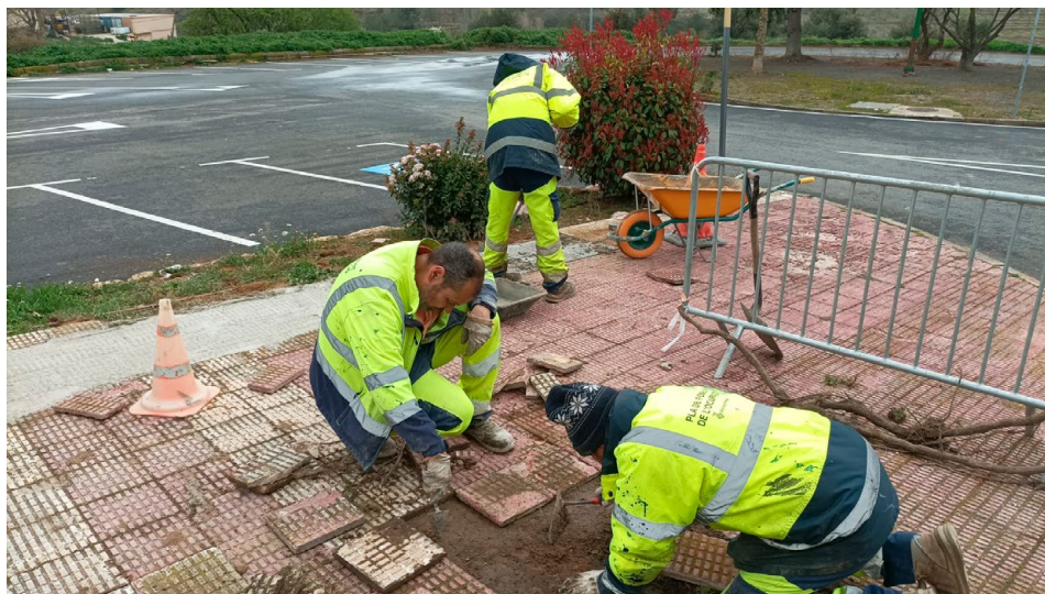
Tasques de manteniment de la vorera al l'avinguda del Priorat, Cornudella del Montsant
