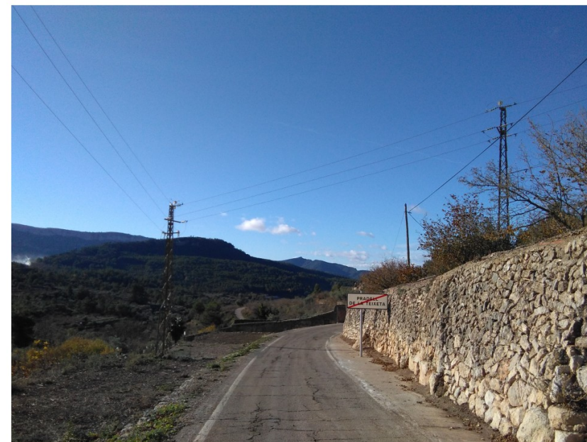
16. Tram inicial. Creuament línies aèries MT.
