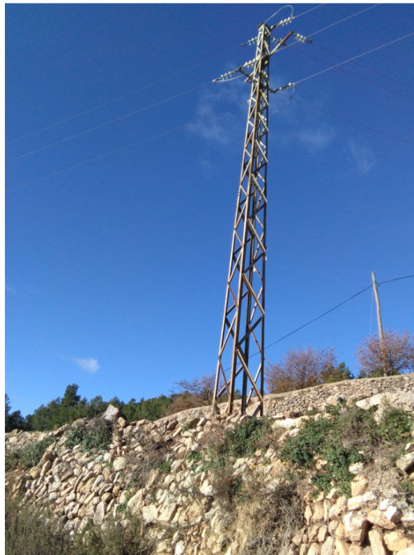
12. Tram inicial. Torre elèctrica MT.
