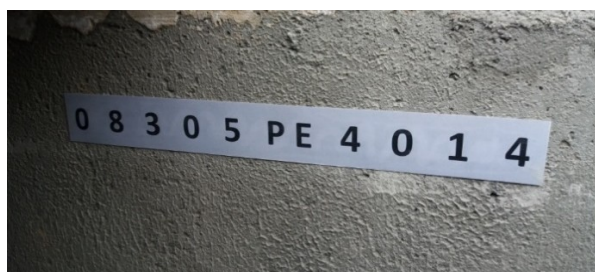
Exemple de retolat interior de pericó
